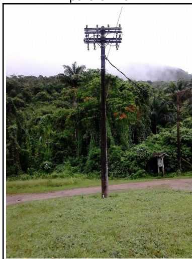
Figura 19 - Poste de fornecimento de energia elétrica para a vila.
